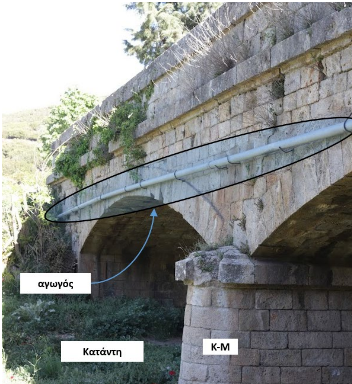
Εικόνα 28 : Αγωγός επί της γέφυρας.
