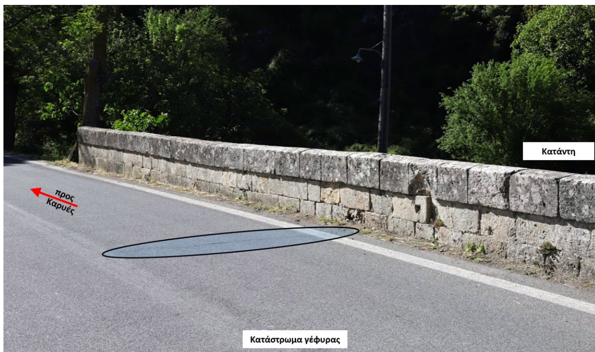
Εικόνα 34 : Εγκάρσια ρωγμή επί του καταστρώματος (γενική άποψη).
