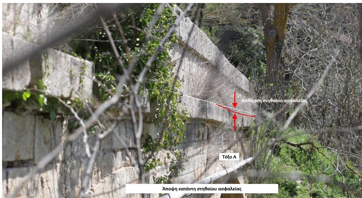
Εικόνα 41 : Καθίζηση του (κατάντη) στηθαίου ασφαλείας.
