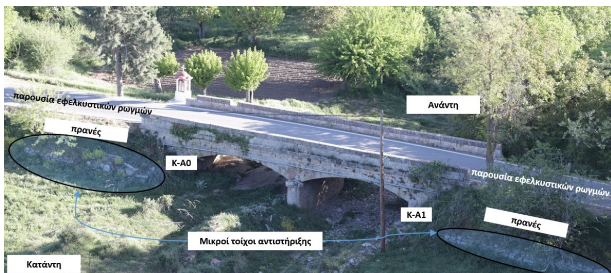
Εικόνα 37 : Ζώνη εφελκυστικών ρωγμών.
