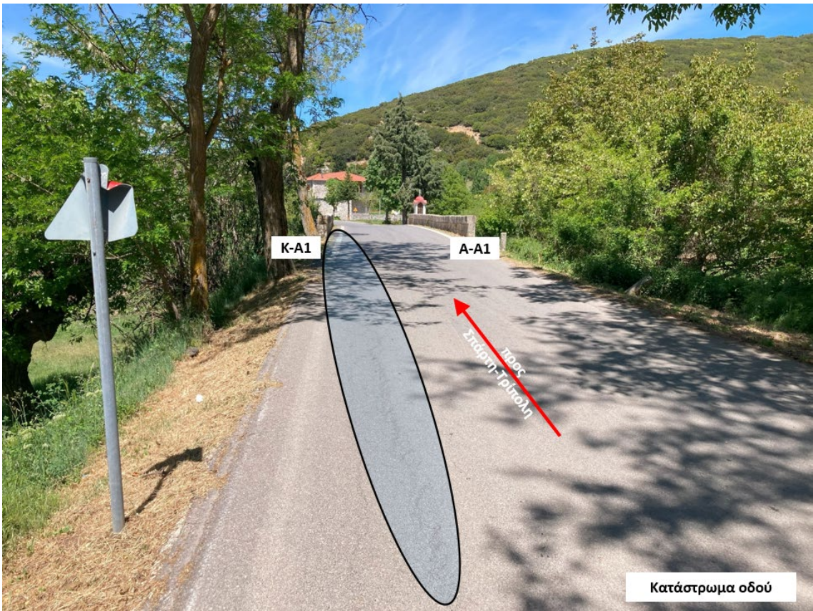
Εικόνα 39 : Διαμήκειες ρωγμές επί του οδοστρώματος (πρόσβαση στο ακρόβαθρο Α1).
